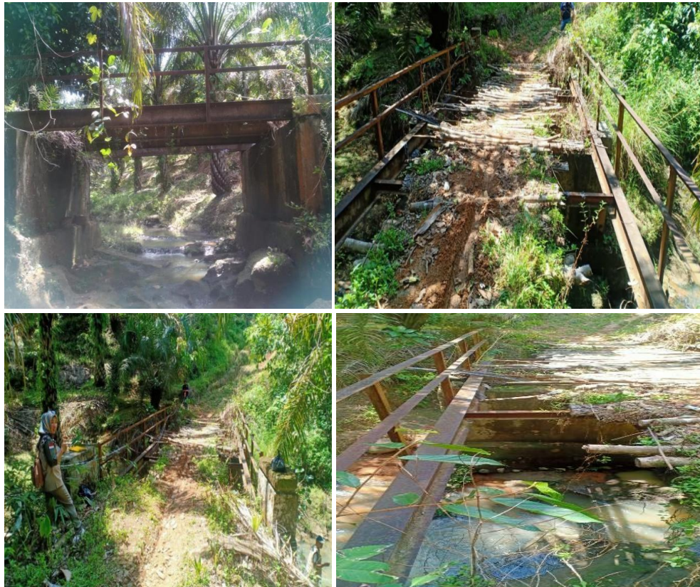
Gambar: Lokasi Pasca Bencana Tanah Longsor dan Banjir
