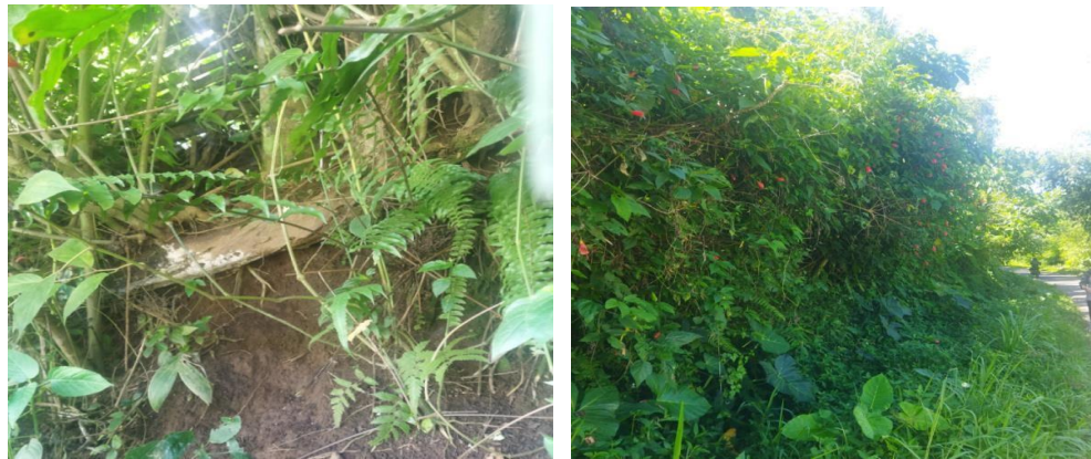
Gambar: Survey Lokasi Pasca Bencana Longsor Desa Kampung Sajad
