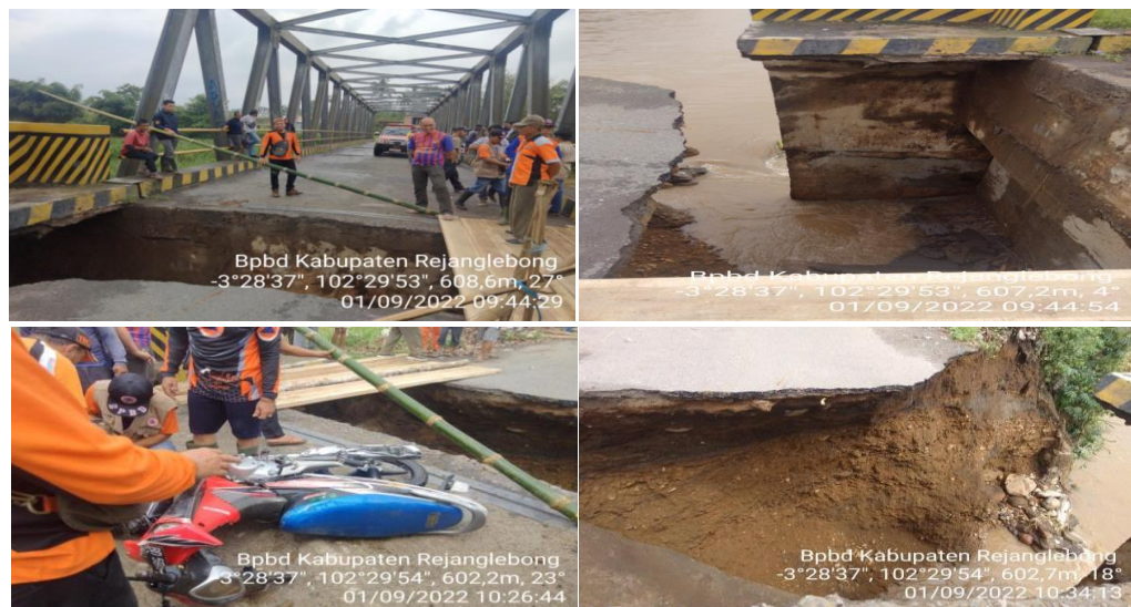
Gambar: Longsor Oprit Jembatan Penghubung Kel. Talang Benih
