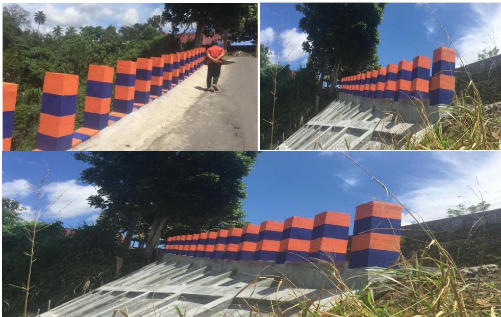
Gambar: Bangunan Penahan Longsor
