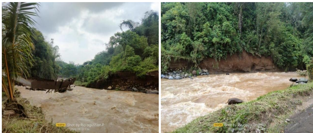
Gambar: Jembatan Gantung Putus Desa Cawang Lama
