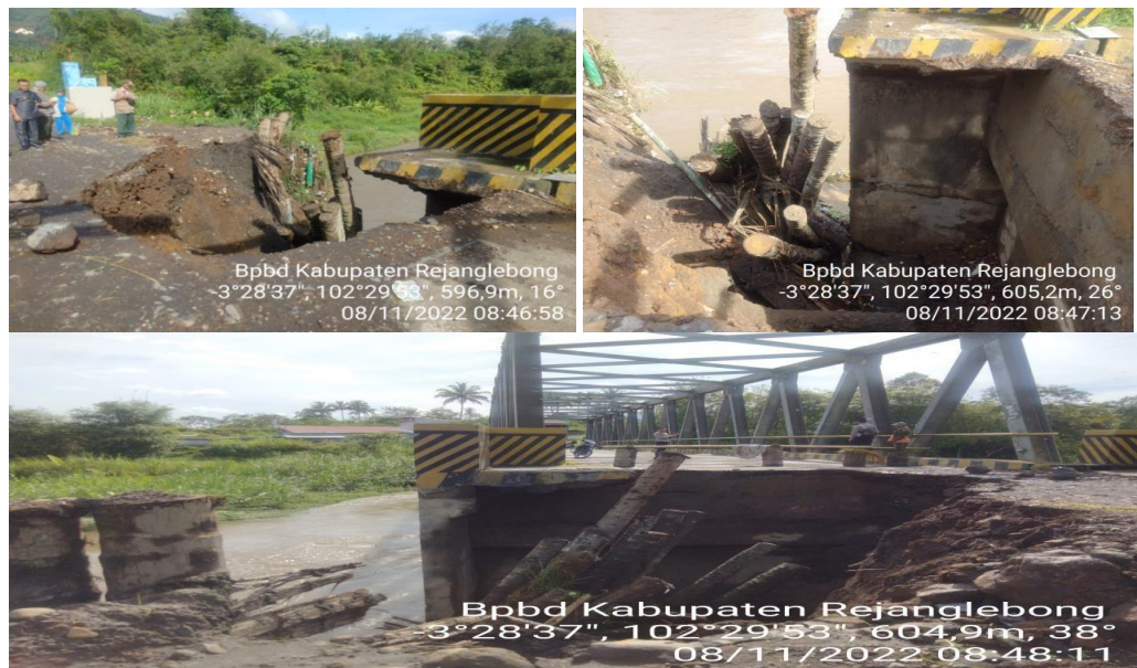
Gambar: Longsor Oprit Jembatan Penghubung Kel. Talang benih dengan dusun Sawah
