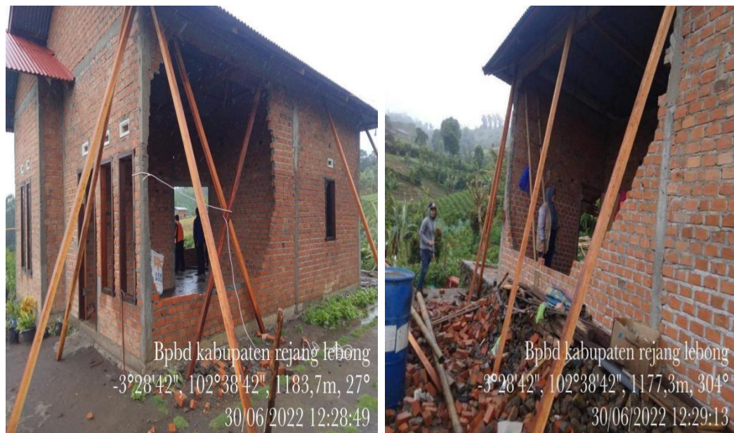
Gambar: Dinding Roboh akibat Angin Deras di Desa Sumber Urip
