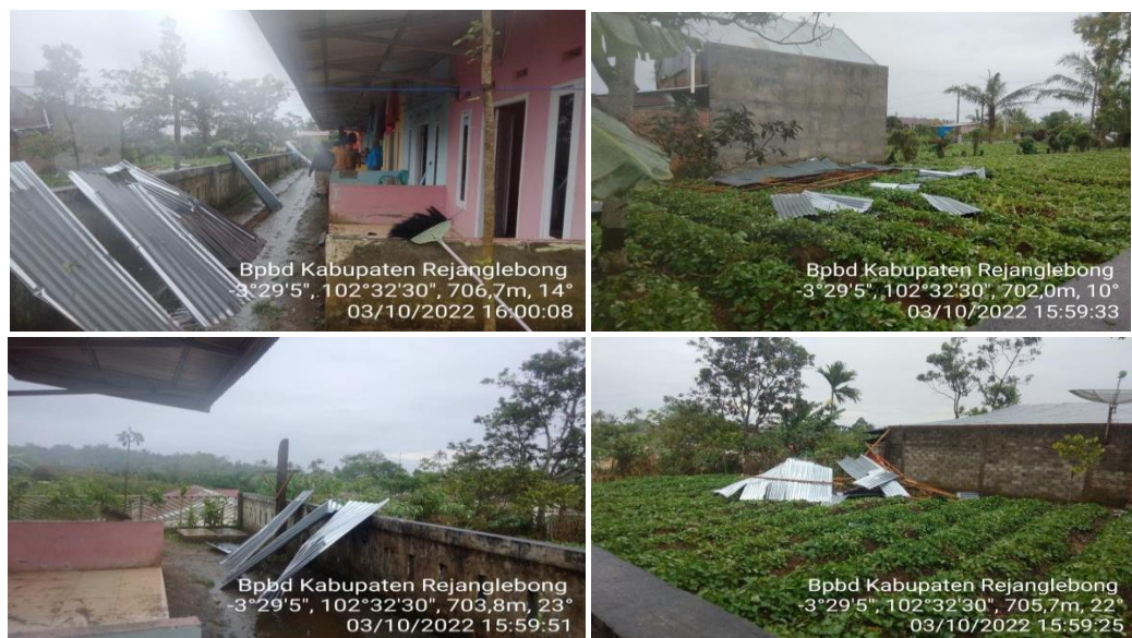
Gambar: Kerusakan akibat Putting Beliung
